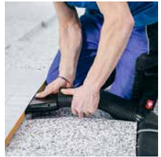
Anschluss der Uponor Comfort Air Panels an den Pluggit Zuluftkanal
