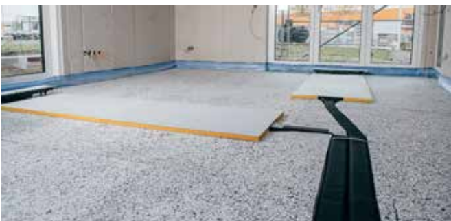
Fertig montiertes Comfort Air System
