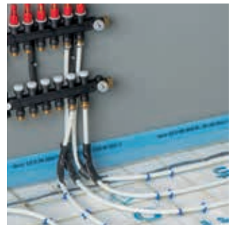
Anschluss des einzelnen Heizkreise an den Uponor Vario PLUS Heizkreisverteiler.
